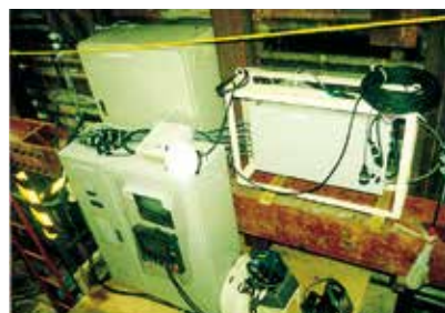
タッチパネル操作盤坑内設置状況
